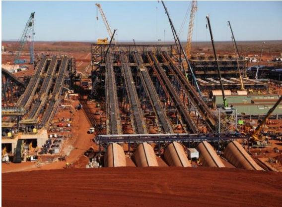
กระบวนการผลิตแร่เหล็ก (Iron Ore Processing Plant) โครงการ Roy Hills ประเทศออสเตรเลีย
