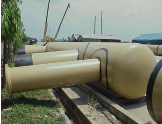
ระบบท่อส่งน้ำ (Pump Discharge Header) โรงไฟฟ้าวังน้อย จังหวัดพระนครศรีอยุธยา ประเทศไทย
