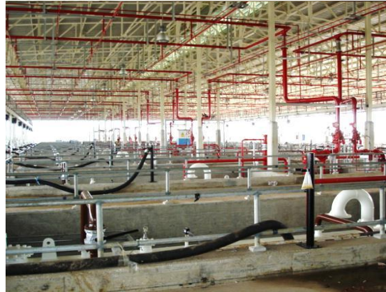
ระบบท่อรับ-ส่งน้ำมัน (Fuel Oil Receiving and Forwarding Facilities) โรงไฟฟ้าราชบุรี จังหวัดราชบุรี ประเทศไทย
