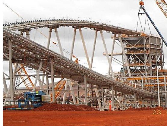
สายพานลำเลียงแร่ (Conveyer) โครงการ Solomon Iron Ores ประเทศออสเตรเลีย
