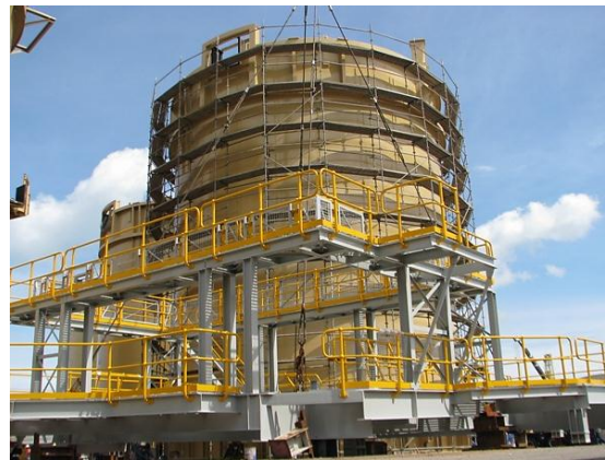
ถังแยกทองคำออกจากสินแร่ โครงการ Lihir Gold Mine - Million Ounce Plant Upgrade (MOPU) ประเทศปาปัวนิวกินี
