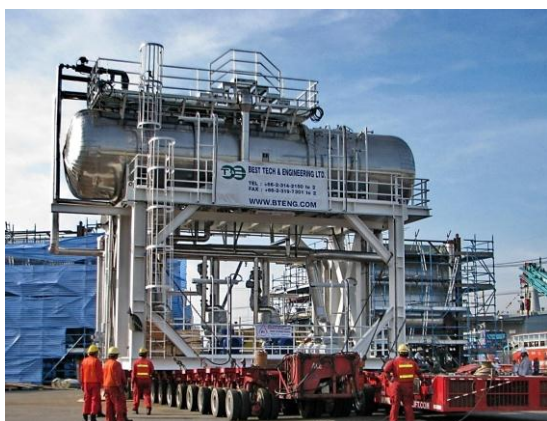
อุปกรณ์แยกอากาศออกจากไอน้ำ โครงการ Golar Winter Renovation of FSRU ประเทศบราซิล
