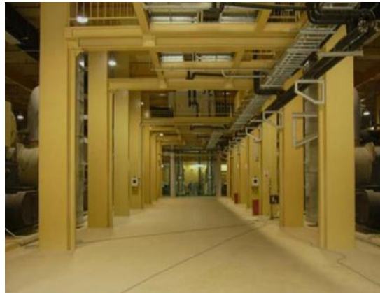
โครงสร้างเหล็กสำหรับระบบน้ำหล่อเย็น (Chilled Water System)
