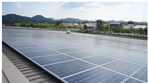
โครงการ PV ประเภท Commercial Rooftop ภายใต้กลุ่ม TSER (หลังคา Homepro)
