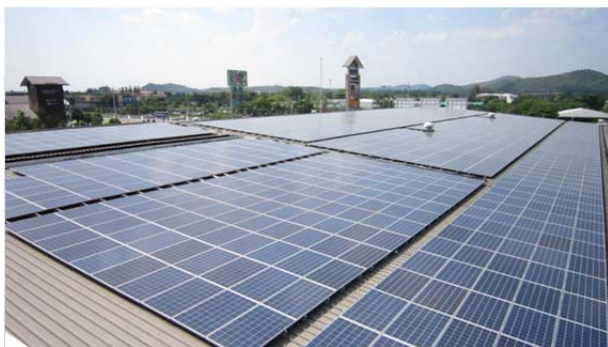
โครงการ PV ประเภท Commercial Rooftop ภายใต้กลุ่ม TSER (หลังคา Homepro)
