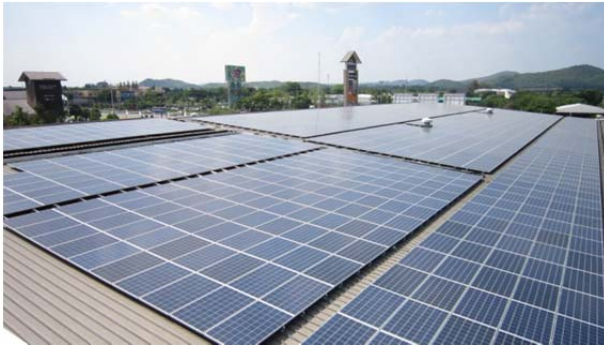
โครงการ PV ประเภท Commercial Rooftop ภายใต้กลุ่ม TSE (หลังคา Homepro)
