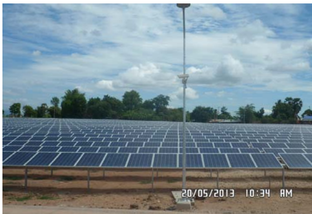
โครงการโรงไฟฟ้า PV ประเภท Solar Farm (SSE1-PV01)
