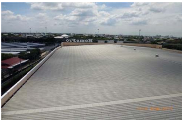
โครงการผลิตไฟฟ้า PV ประเภท Commercial Rooftop ภายใต้กลุ่ม TSER (หลังคา Homepro)
