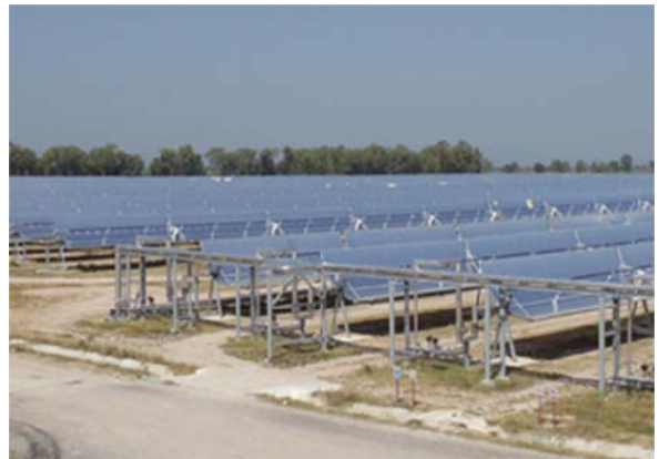
โครงการโรงไฟฟ้า Thermal TSE-01
