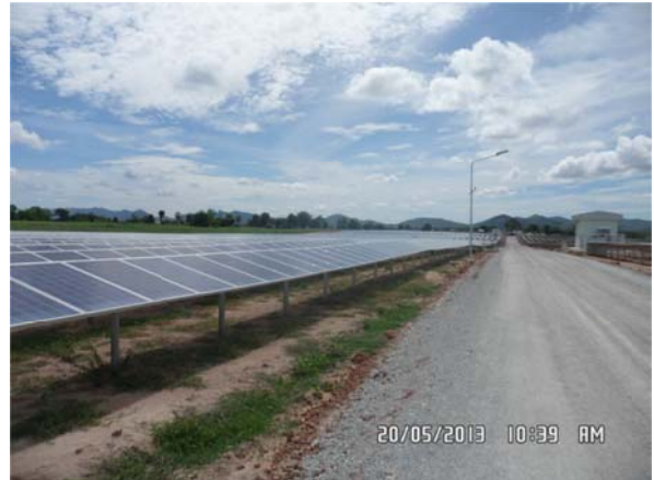
โครงการโรงไฟฟ้า PV ประเภท Solar Farm (SSE1-PV01)
