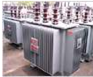
หม้อแปลงไฟฟ้า
