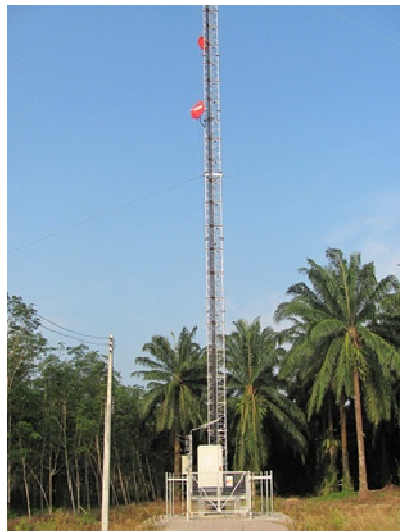
เสาโทรคมนาคมแบบ Guyed Mast Tower
