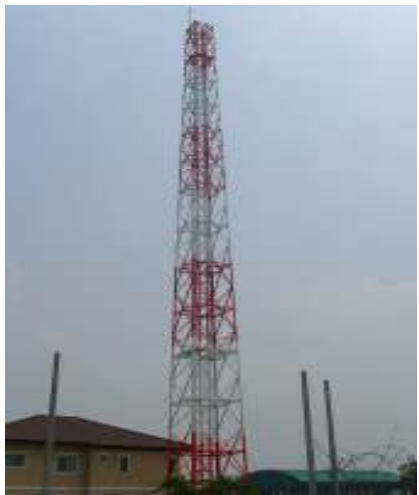
เสาโทรคมนาคมแบบ Self Supporting Tower
