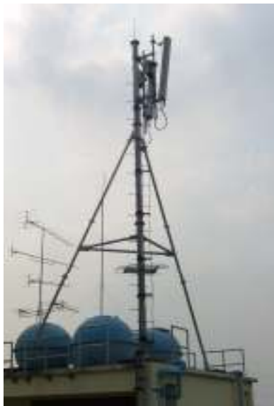
เสาโทรคมนาคมแบบ Pole
