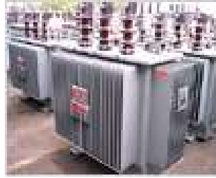
หม้อแปลงไฟฟ้า
