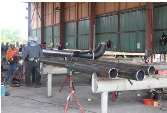
ชิ้นงานระบบท่อที่โรงงานเพื่อรอการนำไปติดตั้ง
